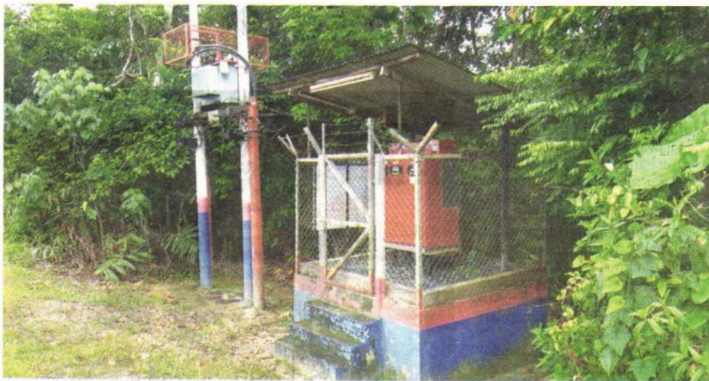
SALAH sebuah pencawang elektrik yang sering ditenggelami air di Kampung Pasir Raja, Hulu Terengganu. - UTUSAN/NIK NUR IZZATUL HAZWANI NIK ADNAN
