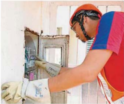
国能职员在天然气管爆炸事故波及的用户住家检查电表，以便确保相关地区电供安全与恢复。（国能供图）
