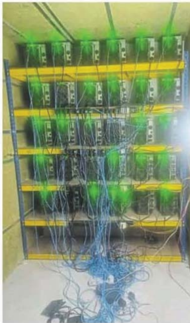
■某地区供出租的单位被发现遭人安装电线，以进行偷电挖矿。
