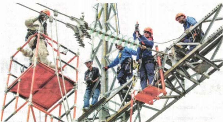
ASAS sektor infrastruktur tenaga kekal disokong oleh aliran projek kukuh daripada TNB, pembangunan pusat data dan inisiatif solar.
