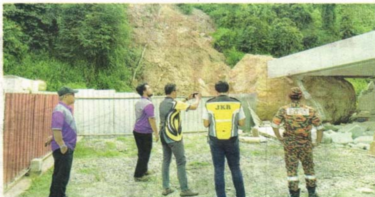
KEADAAN bongkah batu yang menghempap sub stesen TNB di sebuah ladang ternakan di Kampung Raja Musa, Bestari Jaya, Kuala Selangor.
