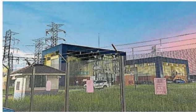
傍晚7时许的玛琳再也主要入电变压器站，没有出现爆炸过的痕迹。
