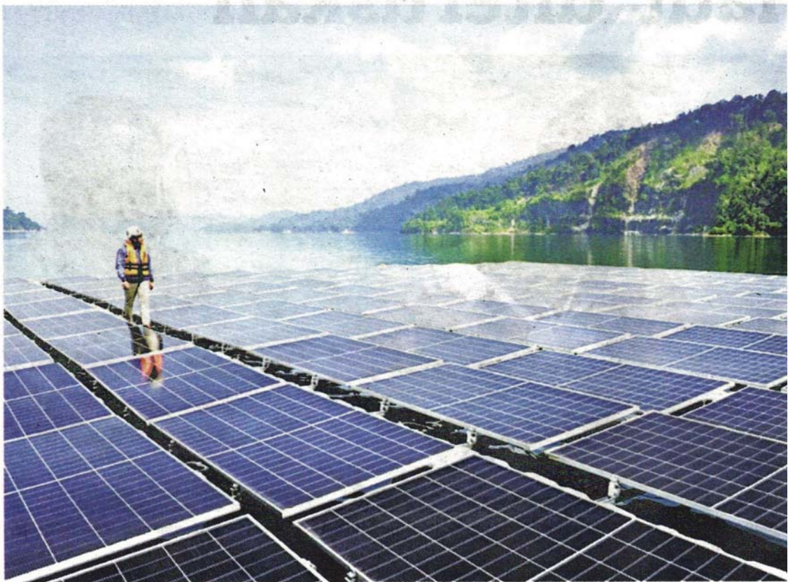
PROJEK solar terapung di Empangan Tasik Kenyir yang menyumbang tenaga bersih ke dalam pembekalan elektrik negara. – GAMBAR HIASAN
