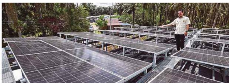
Jurutera Elektrik Penguasa Kanan Jabatan Kerja Raya (JKR) yang juga Ketua Pasukan Projek, Ir Dr Abdul Muhaimin Mahmud menunjukkan panel solar yang digunakan di Kampung Orang Asli Berasau, Kluang, semalam. (Foto BERNAMA)
