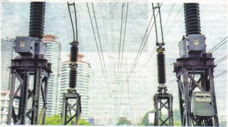
SEKTOR utiliti akan memanfaatkan pembangunan pusat data, pelancaran tenaga boleh diperbaharui (RE) dan perbelanjaan modal TNB.
