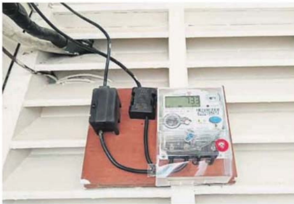
■ 卢贵成住家刚换上的新电表才两个星期，就被国能指偷电。
