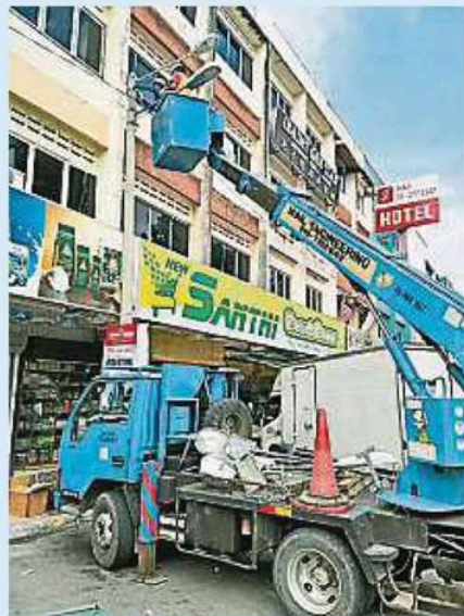
▲ 国能人员正在更换文德甲哈芝卡欣路失灵路灯。
