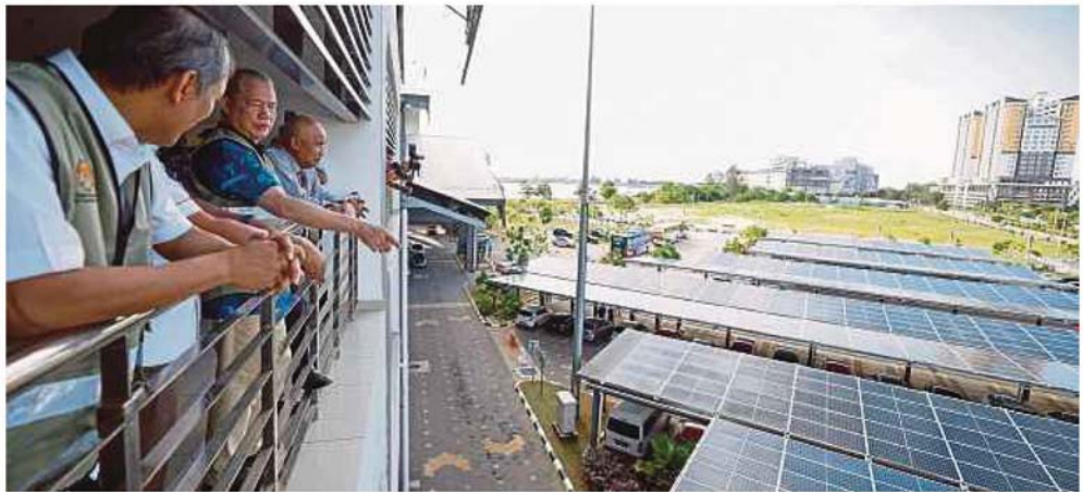
Fadillah melihat sistem Solar PV yang dipasang di bumbung tempat letak kenderaan Menara Majlis Bandaraya Kuala Terengganu pada program PETRA Skwad Zon Timur ke Kelantan dan Terengganu, semalam. (Foto BERNAMA)
