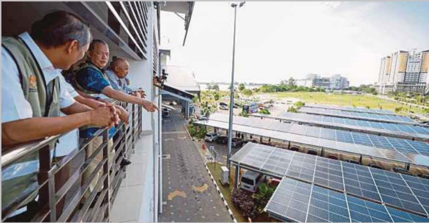
TIMBALAN Perdana Menteri yang juga Menteri Peralihan Tenaga dan Transformasi Air (Petra) Datuk Seri Fadillah Yusof (tengah) melihat Sistem Solar PV di bumbung dan ruang tempat letak kenderaan di Menara Majlis Bandaraya Kuala Terengganu ketika mengadakan lawatan kerja ke sana sempena Program Petra Skwad Zon Timur ke Kelantan dan Terengganu, semalam.
